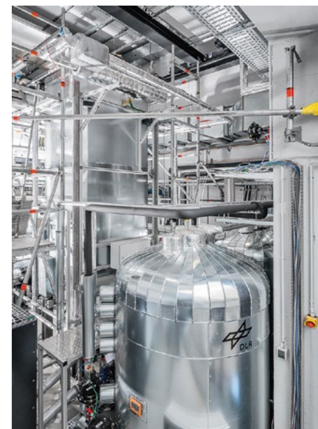
Carnot-Batterien speichern Strom in Form von Wärme. Das DLR und das CHESTER-Konsortium (Compressed Heat Energy Storage for Energy from Renewable Sources) bauten die weltweit erste Carnot-Batterie auf Basis von Dampfkraft-Prozessen.
